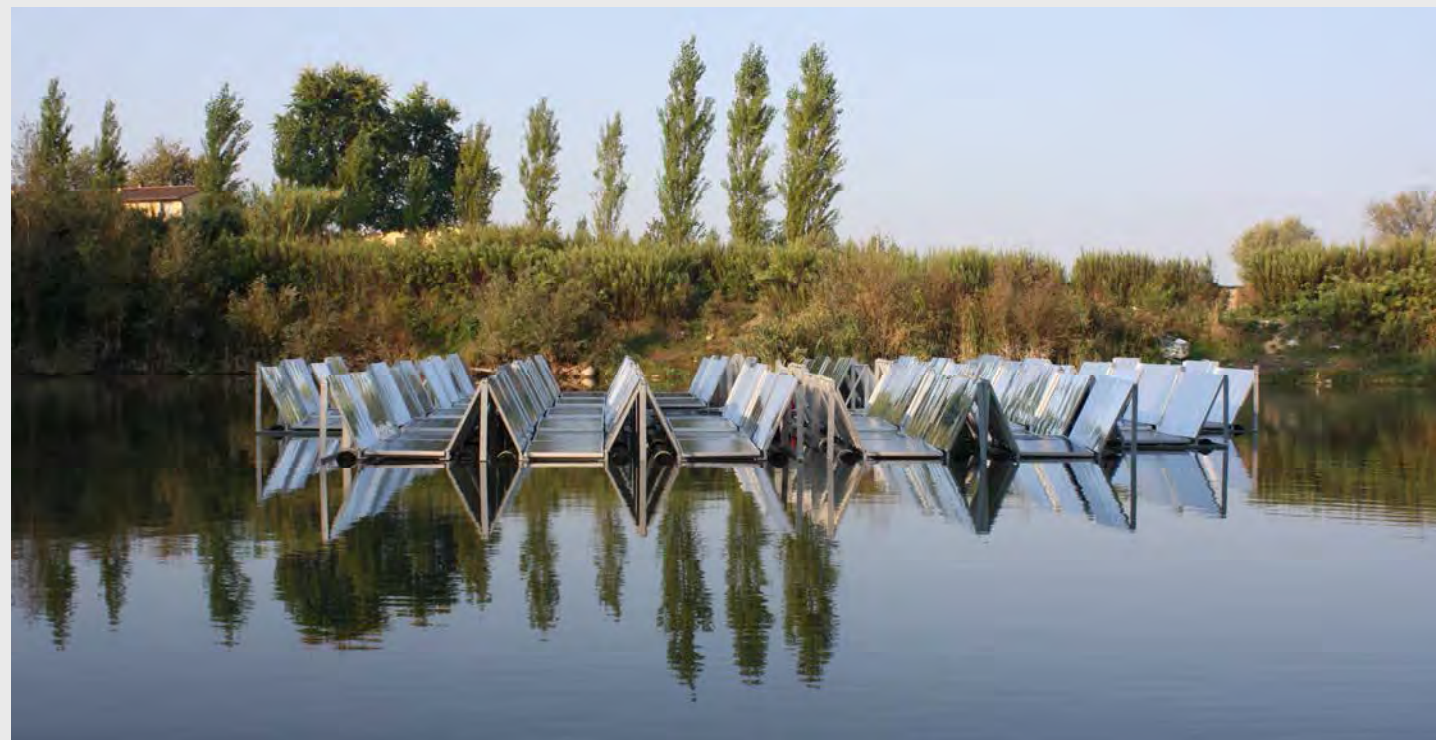
2. Impianto fotovoltaico galleggiante. Colignola
