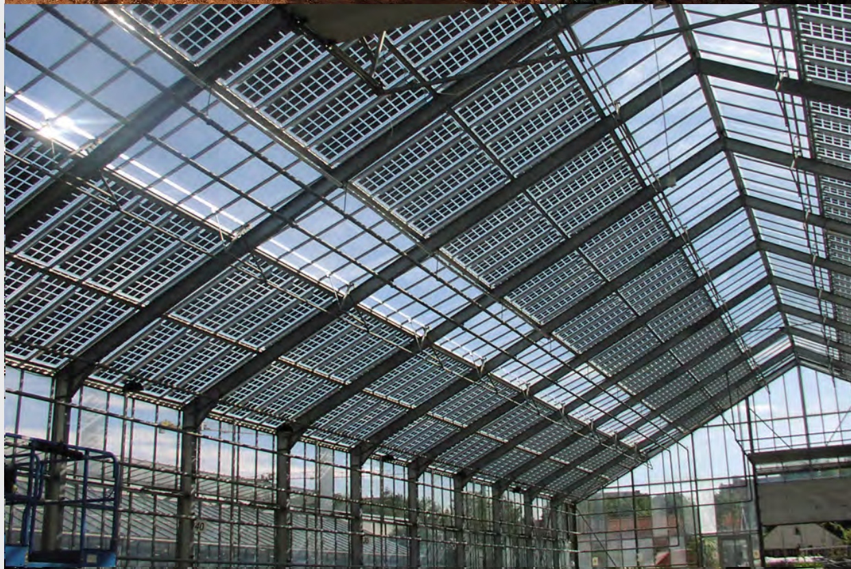
Impianto fotovoltaico su serra agricola
