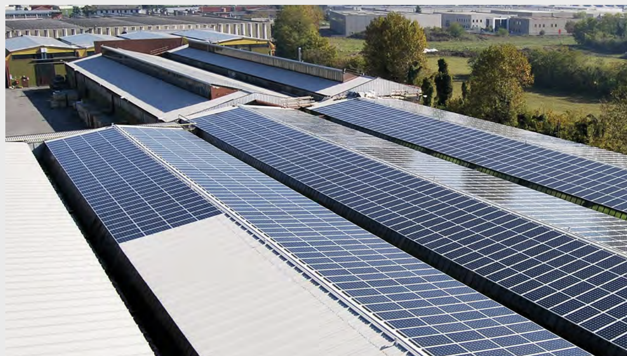
Impianto fotovoltaico integrato su capannone industriale.
