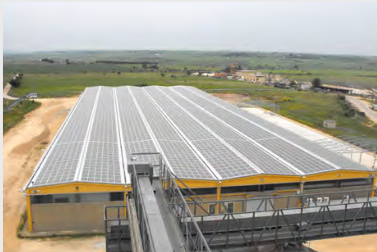
Impianto fotovoltaico italiano totalmente integrato su tetto a falda. Altamura (Bari)
