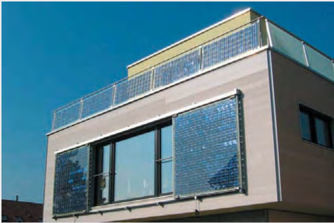
Schermature e parapetti fotovoltaici. Svizzera
