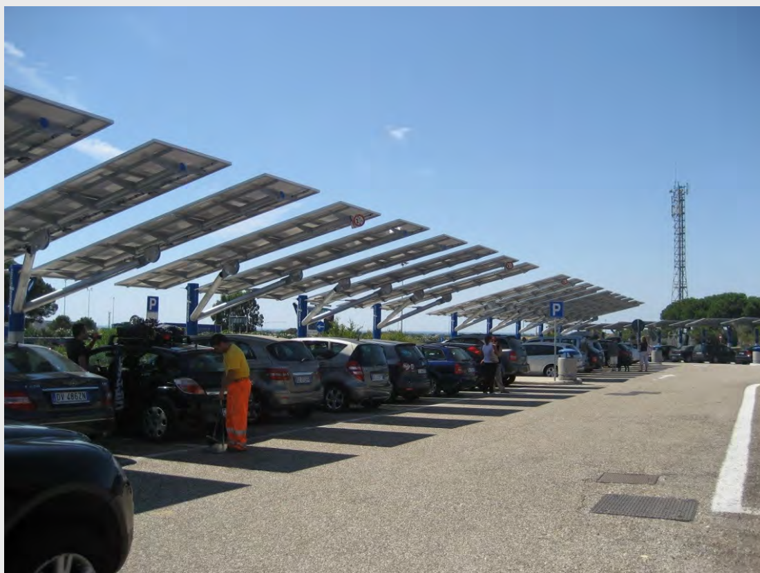
Pensiline fotovoltaiche per parcheggi in stazioni di servizio AGIP lungo l'autostrada A14
